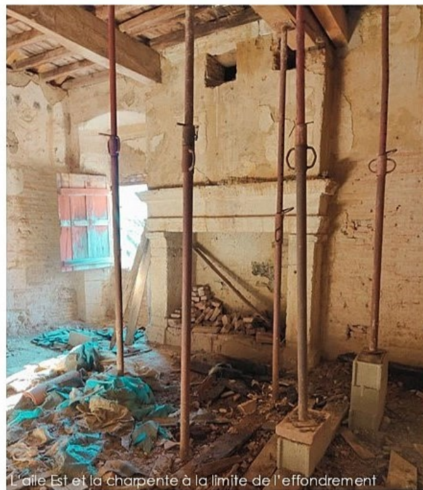
L'allée Est et la charpente à la limite de l'effondrement
